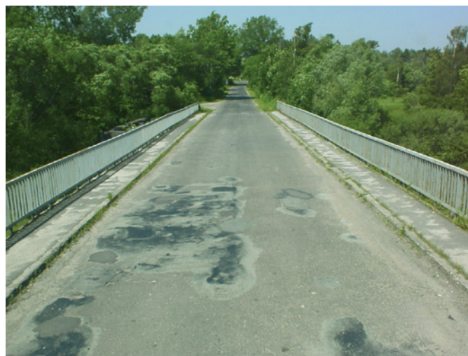
Stary most położony wzdłuż drogi powiatowej już wkrótce zmieni wygląd
