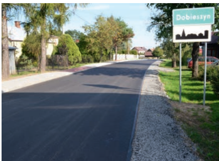
Przebudowa drogi polegająca m.in. na wykonaniu nowej nawierzchni w Jedliczu i Dobieszynie oraz budowie chodnika w Dobieszynie
