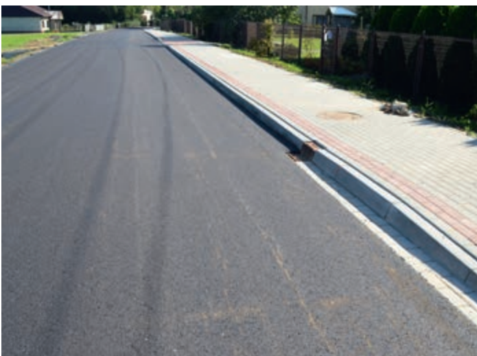
Przebudowa drogi polegająca na poszerzeniu, położeniu nowej nawierzchni, budowie chodników oraz przebudowie skrzyżowań w Iskrzyni
